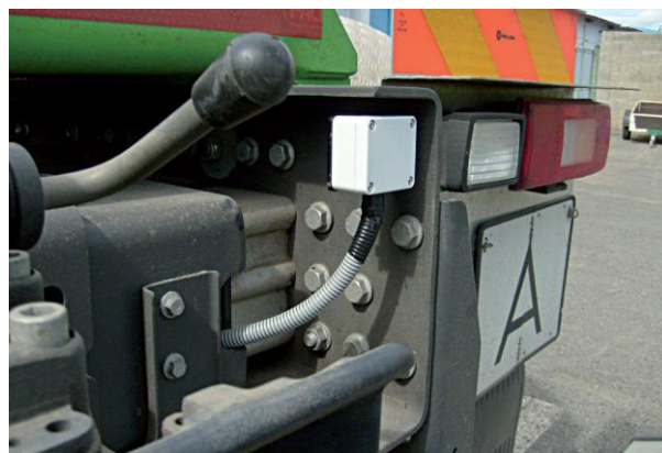
Instalace CWI přijímače na zádi vozu (světle šedý box)
